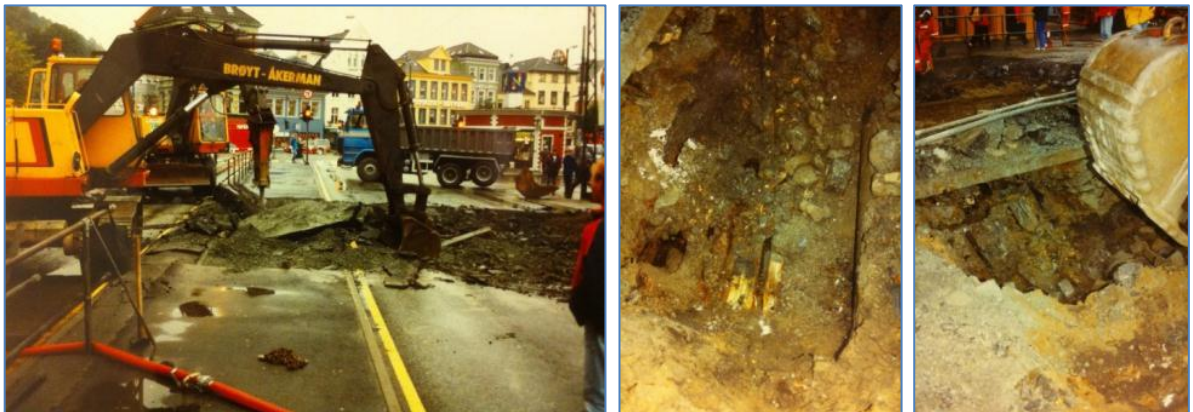
Figur 7: Fra vannledningsbruddet i 1996. Tømmerkassen kan skimtes til venstre for vannledning på bildet i midten (NIKU 22327).
